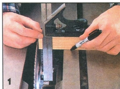
Установив диск циркулярки на расчетную высоту для выборки галтели, отмечают положение его оси на столе.
